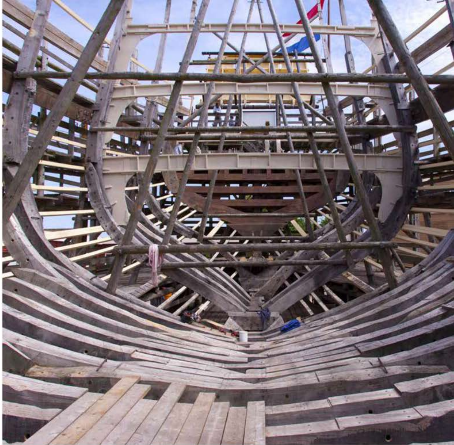
Na de kiel en de stevens worden de spanten geplaatst. Zo zie je de bolle buikvorm al ontstaan. Lange houten onderdelen worden van verschillende stukken hout gemaakt. Je ziet hier een manier om ze aan elkaar te zetten.
